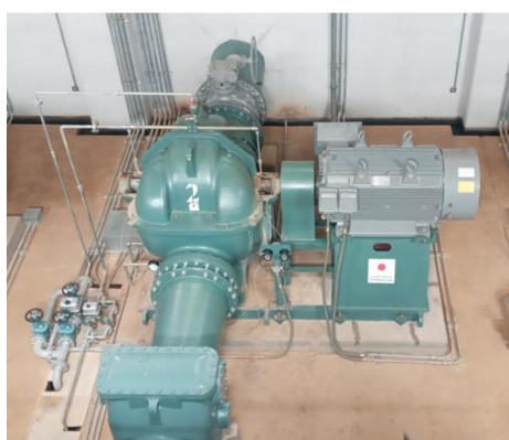
無償資金協力事業で整備されたポンプ場内部（アリアブ地区ポンプ場）
